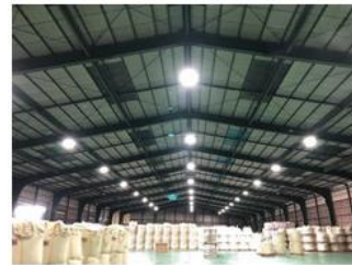
省エネ施工後(エコ太郎 150W×30 灯)
