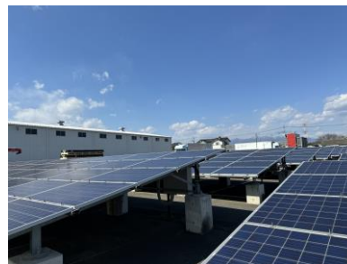
太陽光パネル
